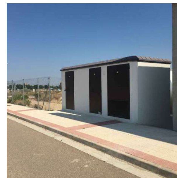
VISTA 02 CENTRO DE TRANSFORMACION
