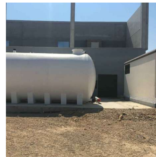
VISTA 03 DEPÓSITOS CONTRA INCENDIOS
