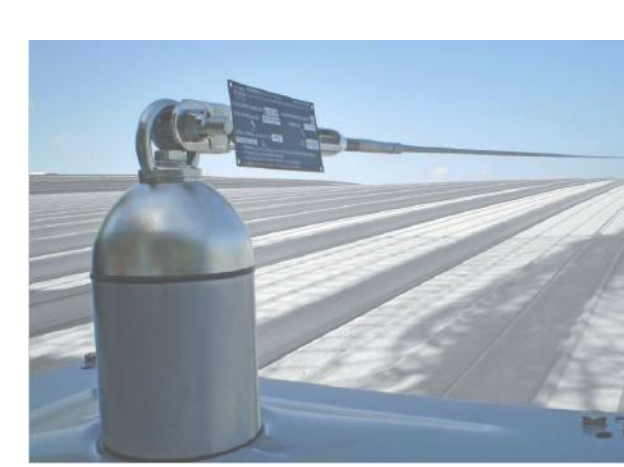
LÍNEA DE VIDA CUBIERTA DECK
